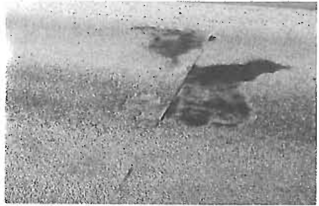
Figure 4 – Dégradation locale d'un revêtement mince due à l'absence de meulage des cordons de soudure de raboutage.
