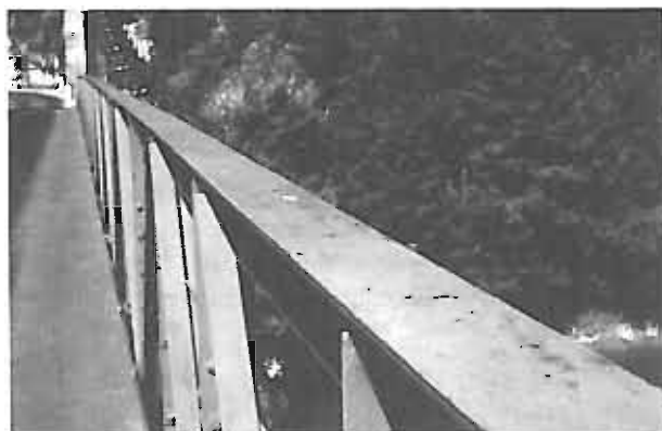
Figure 2 – Type de structure dont l'entretien ne permet pas le choix d'une peinture riche en zinc.
